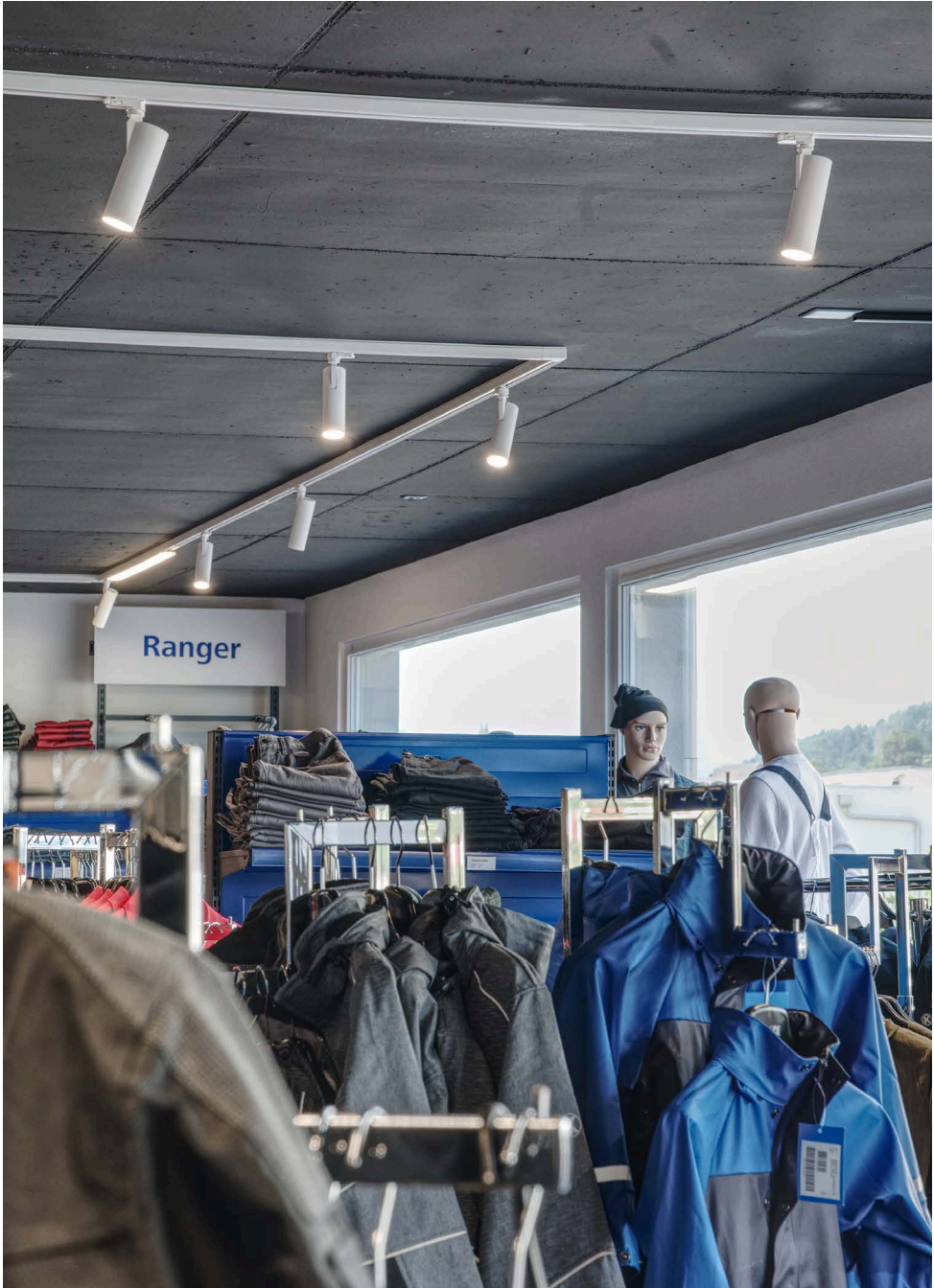
3-Phasen-Stromschienen mit DELIGHT Strahlern im Showroom der Rudolf Krenger AG, Wiedlisbach | ©AKA Leuchten AG
