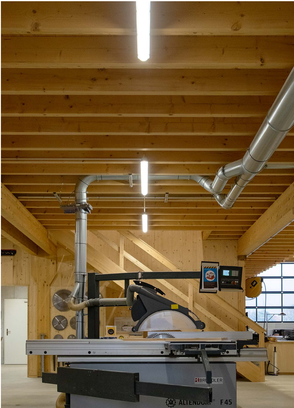
Feuchtraumleuchte RESISTO in der Werkstatt der Schärli Holzbau AG, Deitingen | ©AKA Leuchten AG
