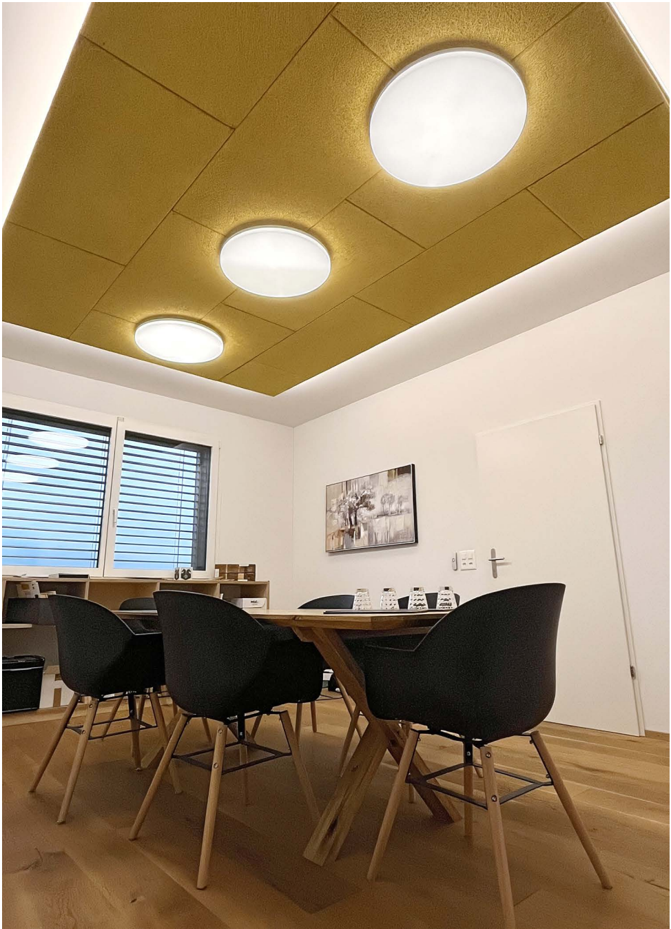
Anbauleuchte SLICE CIRCLE VI N im Sitzungszimmer der Schärli Holzbau AG, Deitingen | ©AKA Leuchten AG
